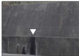
地下水の流出
